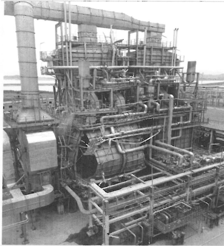
图五：蒸汽过热炉单元“2·18”闪爆事故现场
